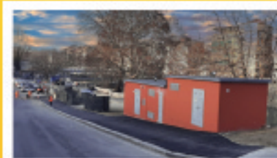
Nuova cabina elettrica a servizio delle stazioni di sollevamento di Lungo Dora Agrigento e Via Borgo Dora
